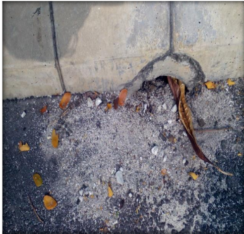
Rajah 2. Erong salir yang tersumbat oleh penurapan baru jalan.
