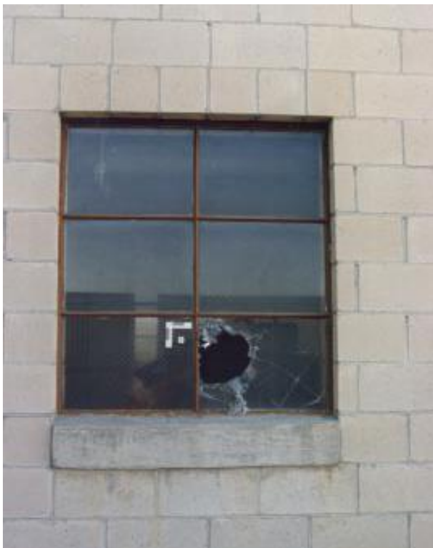
Rajah 5. Tingkap Pecah, Sebelah Selatan
